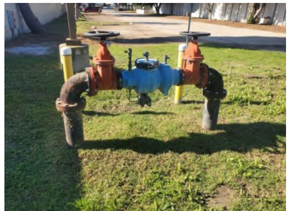
0042048e 4/2/2024 6-inch backflow preventer Site
