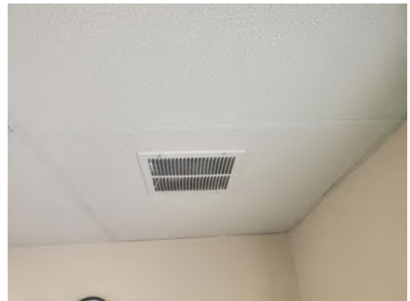
0042018e 4/2/2024 PTAC supply vent Office, lobby
